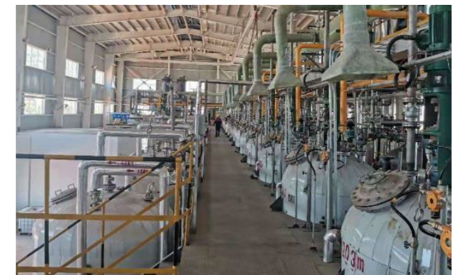
图：含氟硝基苯中试装置
