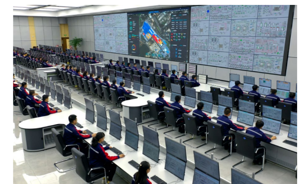
图：天安化工集中控制室
