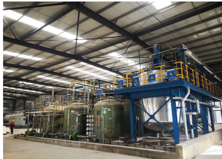
图：1,000 吨磷酸铁铁法工艺中试装置
